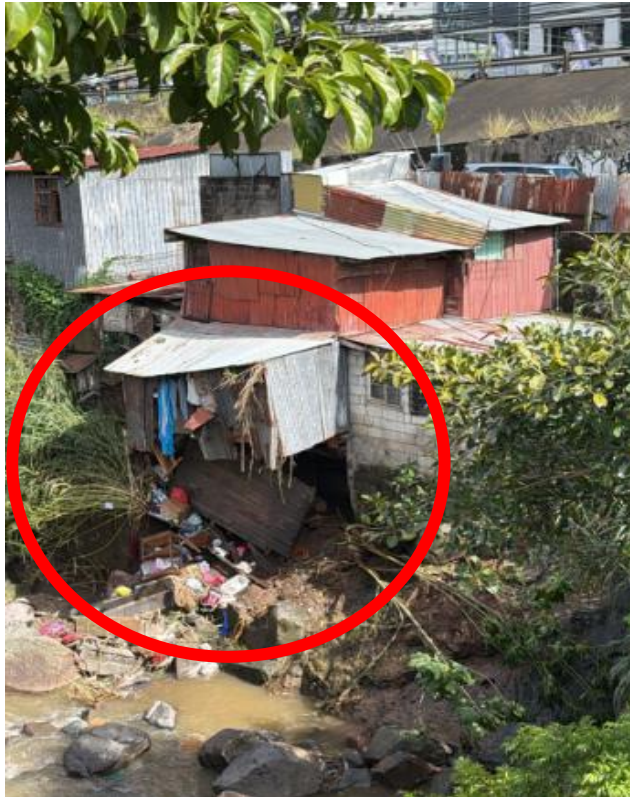
Foto 3: Vivienda colapsada en el barrio Bajo Torres, Uruca
